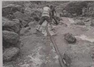
La tubería que abastece a la Junta de Agua.
