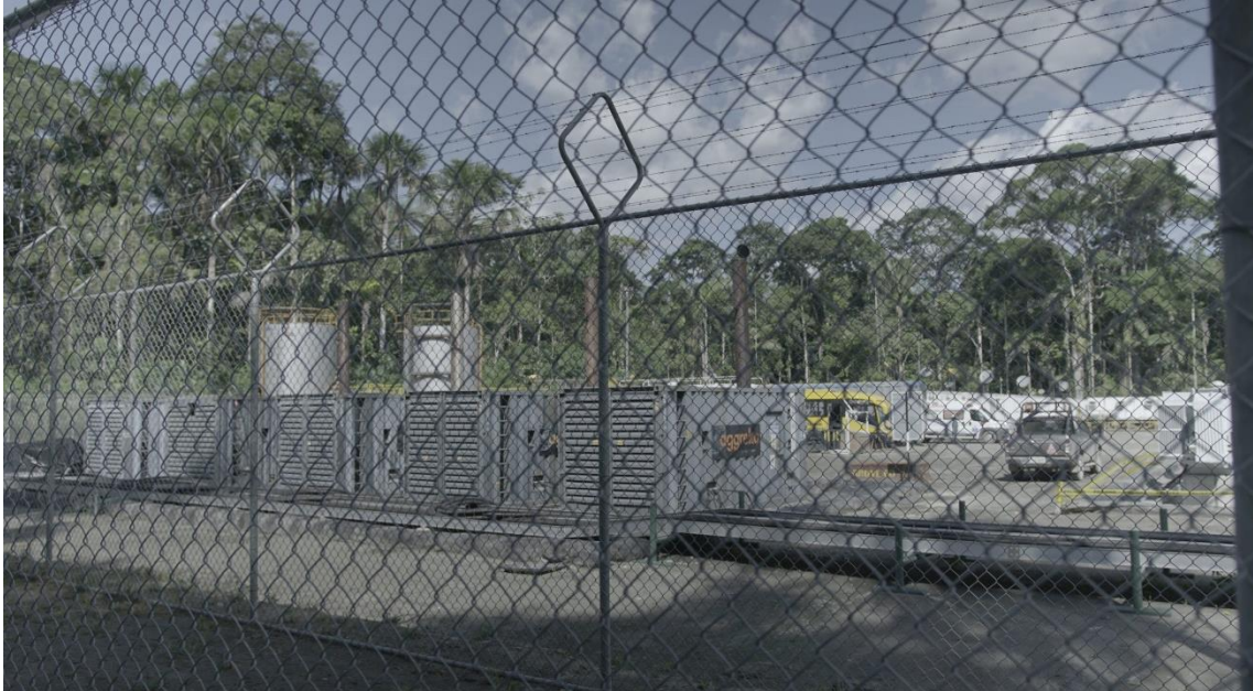
Figura 1: Fotografía de los generadores eléctricos en las plataformas Tambococha A y D, situadas dentro del Parque Nacional Yasuní:
