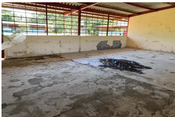
Foto 10 Escuela Baron de Humboldt – Aula deteriorada
