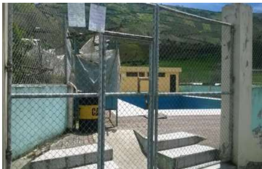
Fotografía 19: Piscina con fisuras
