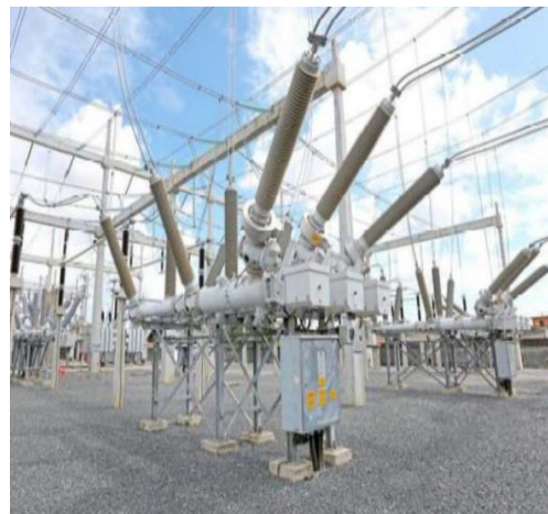
Imagen 6. Equipos de alta tensión
