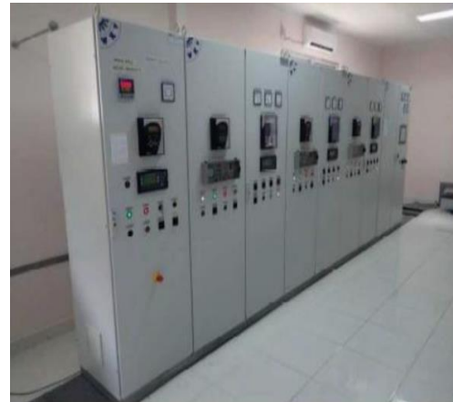
Imagen 4. Equipos de baja tensión para control y protección
