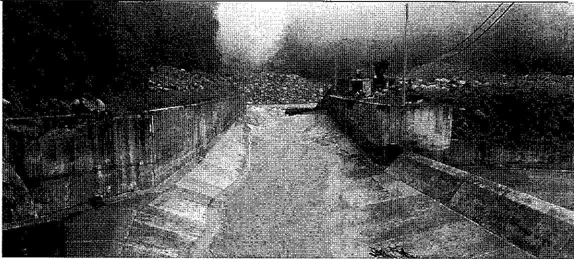
Embalse y vertedero para el control de los excedentes de caudal (foto 4)
