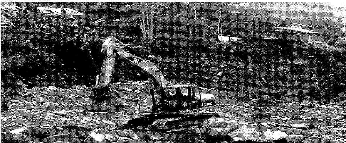
Construcción muro de contención en ribera izquierda del Río Dulcepamba que protege al talud del recinto San Pablo de Amalí (foto 11)
