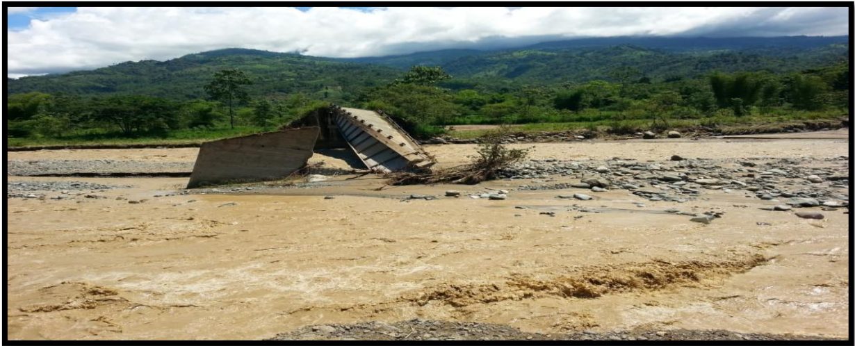
Foto # 1 Puente destruido en el sector de Saltadero
