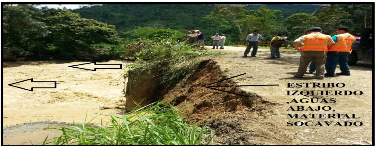
Foto # 3 Puente Dulcepamba, deterioro del relleno estribo izquierdo aguas abajo.
