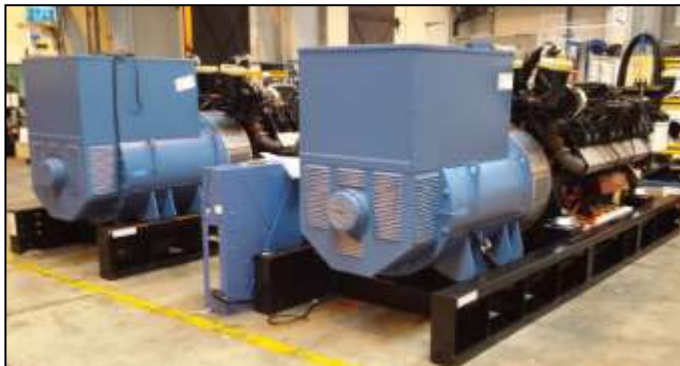
Figura 6 Capacidad instalada para generación
