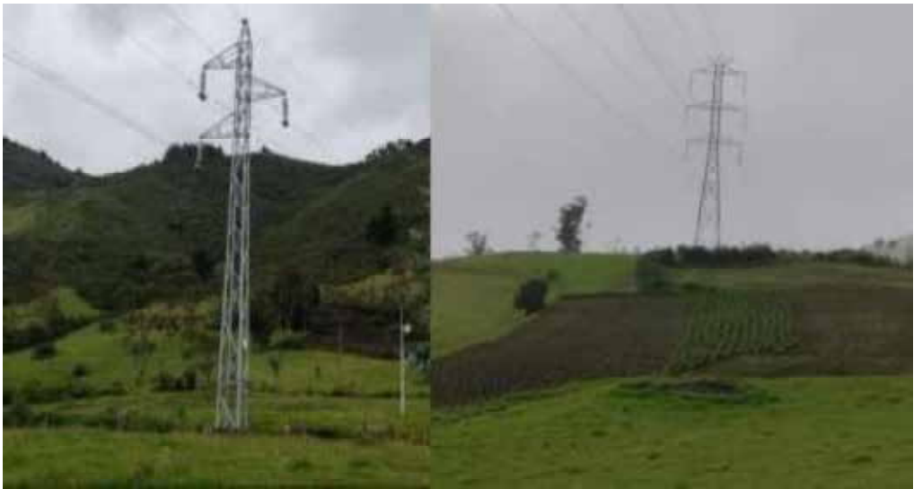
Figura 37. Sistema de Transmisión de Energía eléctrico.
