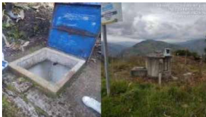
Figura 33. Captación de agua de la parroquia Cañi.
