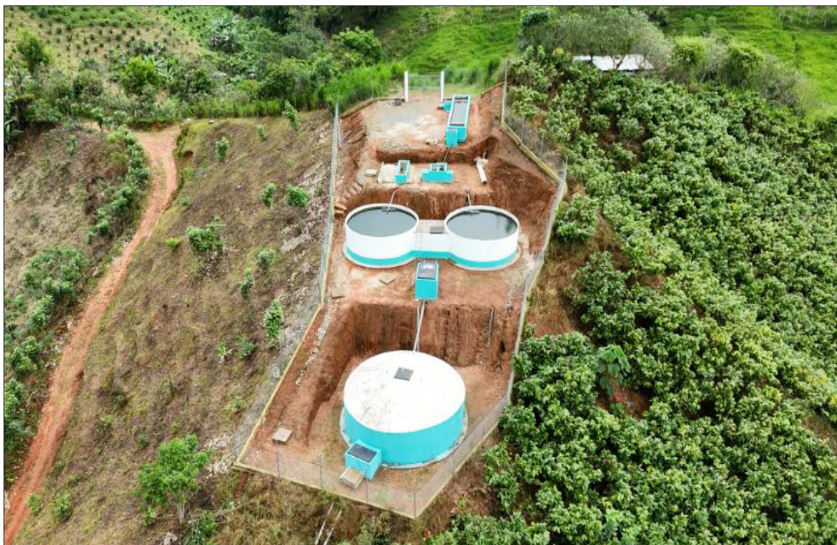
FOTO 28. Sistema de agua potable para la cabecera parroquial de San Isidro
