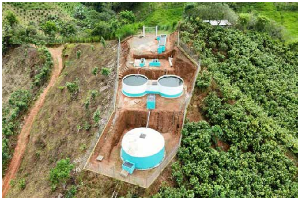
FOTO 16. Sistema de agua potable para la cabecera parroquial de San Isidro
