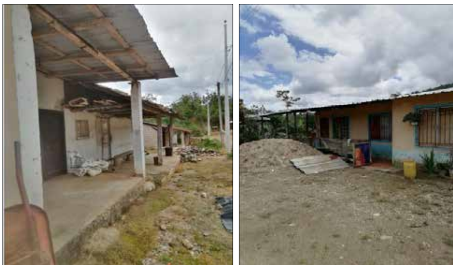
FOTO 30. Condiciones de las viviendas de la Parroquia San Isidro
