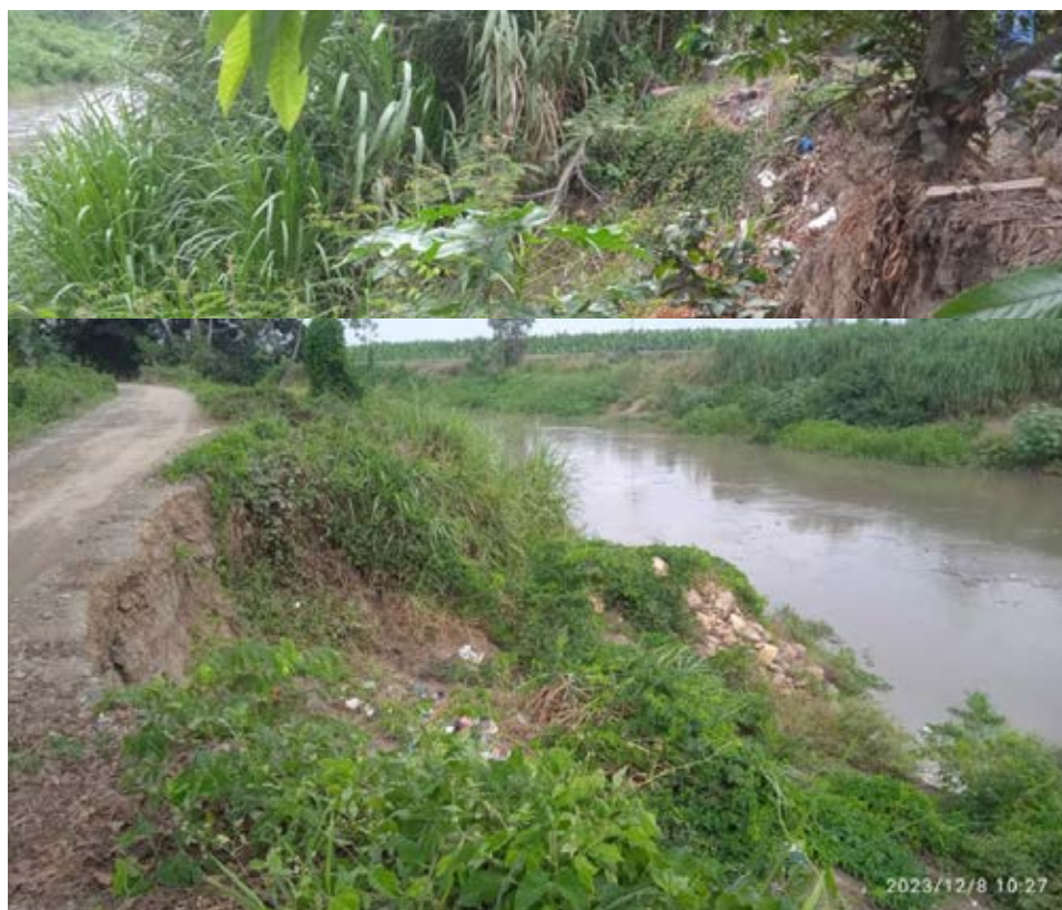
Gráfico 2: Deslizamiento de tierra en la parroquia
