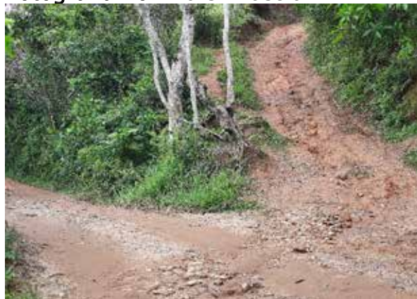
Fotografía 10. Vía sin lastrar
