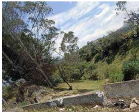
Fotografía 5. Muro en mal estado barrio Unachi
