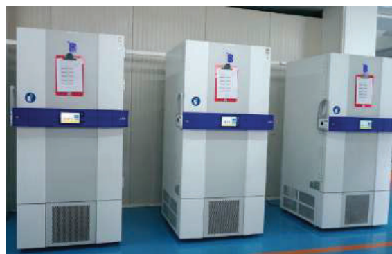
Ultracongeladores ubicados en el primer piso del banco nacional de vacunas.
