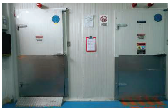
Cámaras frías ubicadas en el segundo piso del banco nacional de vacunas.
