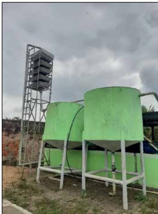
Gráfico 19: Pozo de agua con tanque elevado en el recinto Mesada de arriba
