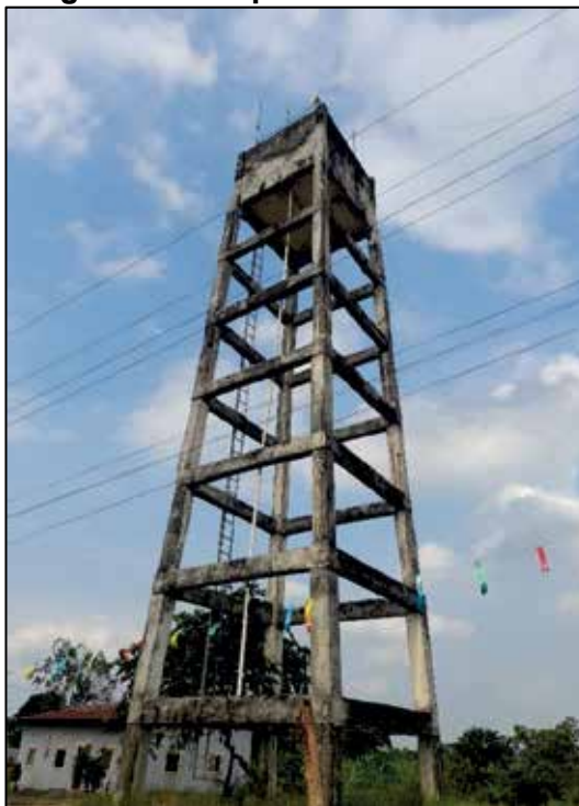
Gráfico 17: Pozo de agua con tanque elevado en el recinto Centinela
