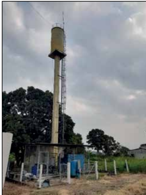
Gráfico 18: Pozo de agua con tanque elevado en el recinto San Eduardo
