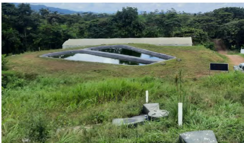
ILUSTRACIÓN 5. TANQUES IMHOFF, LAGUNAS DE MORTANDAD, LECHO DE SECADO
