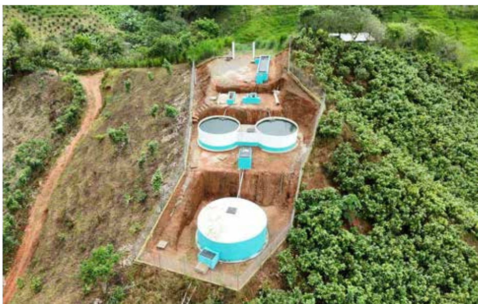
FOTO 23. Sistema de agua potable para el sitio Morales de la Parroquia El Paraíso
