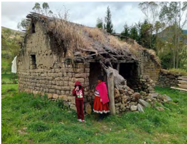
Foto 65. Vivienda en precarias condiciones
