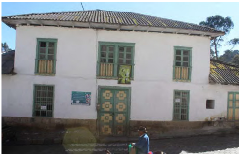
Foto 68. Infraestructura patrimonial en riesgo "Convento Parroquial"
