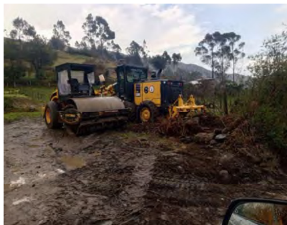
Foto 54. Lastrado de las vías utilizando material inapropiado
