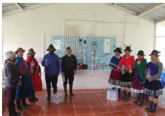
Foto 71. Planta envasadora de agua
