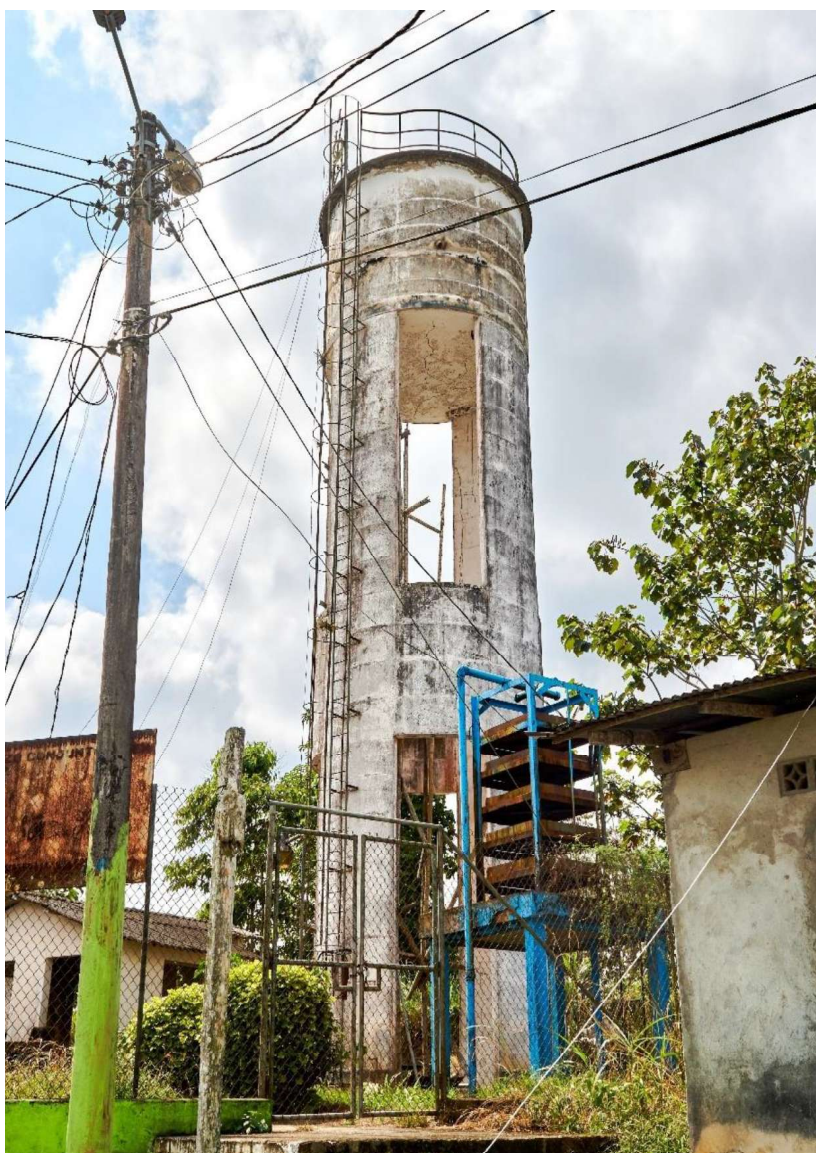
Imagen 15. Sistema de agua potable en la cabecera parroquial
