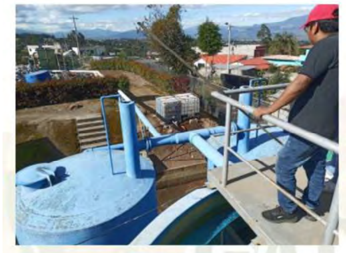
Ilustración 7 Planta de tratamiento
