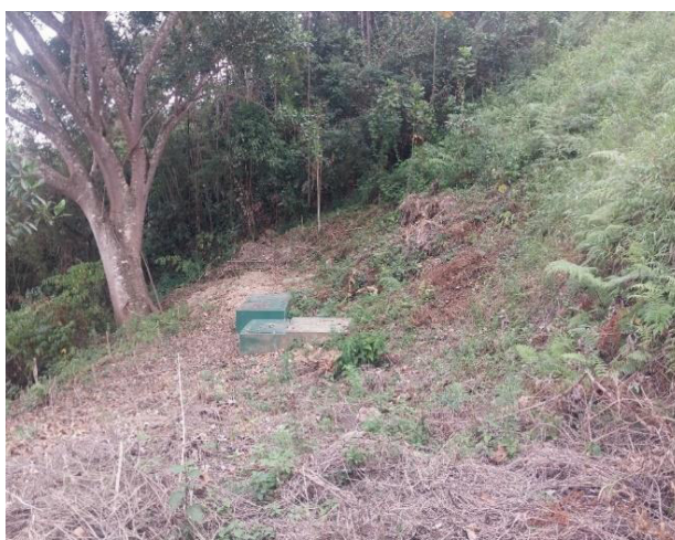
Figura 8. Tanques de tratamiento de aguas residuales, parroquia rural La Chonta
