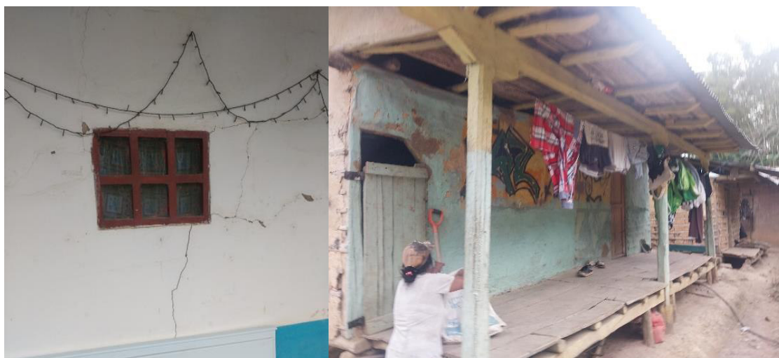
Figura 15. Vivienda del Barrio Central y Shingushi en mal estado, parroquia rural La Chonta
