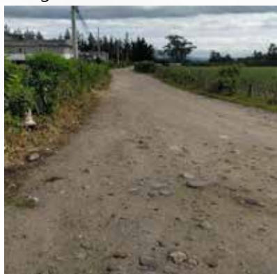
Fotografía 8. Estado de la infraestructura vial
