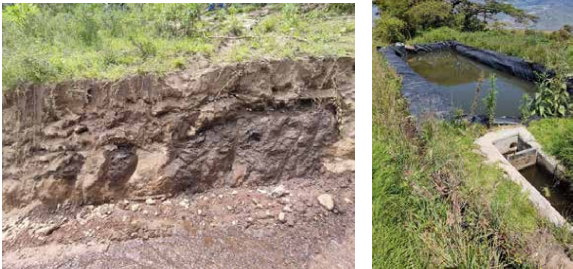
Imagen 10. Acumulación de agua en niveles internos debido a la filtración de agua de líneas de riego y reservorios.
