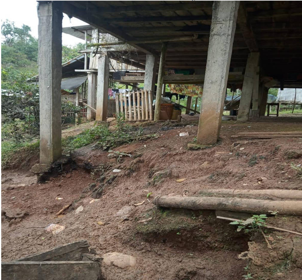
Ilustración 11. Vivienda en riesgo
