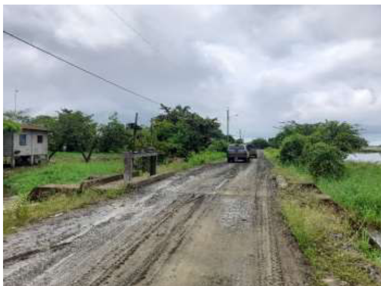
Gráfico 11: Vía en mal estado
