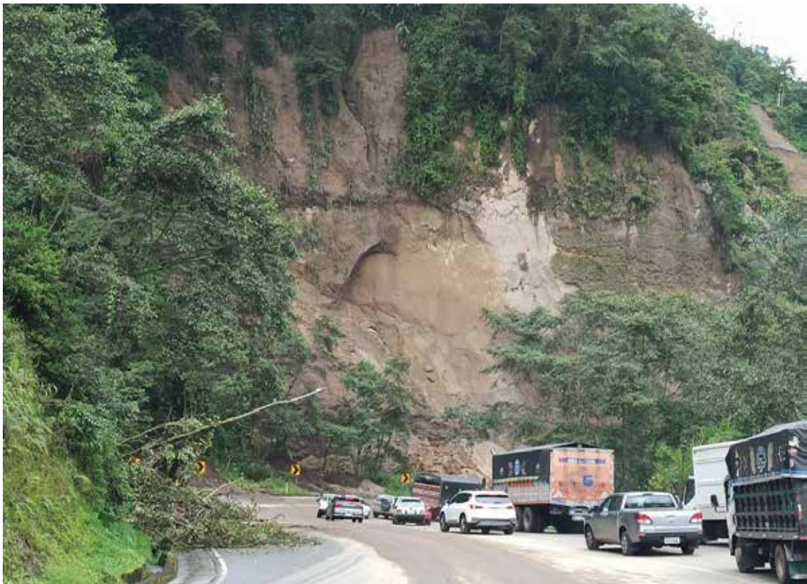
Ilustración 15.Deslizamiento Vía Alóag – Santo Domingo.
