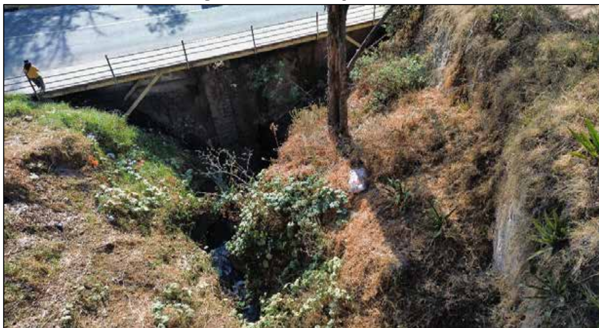
Imagen 7. Contaminación aguas residuales
