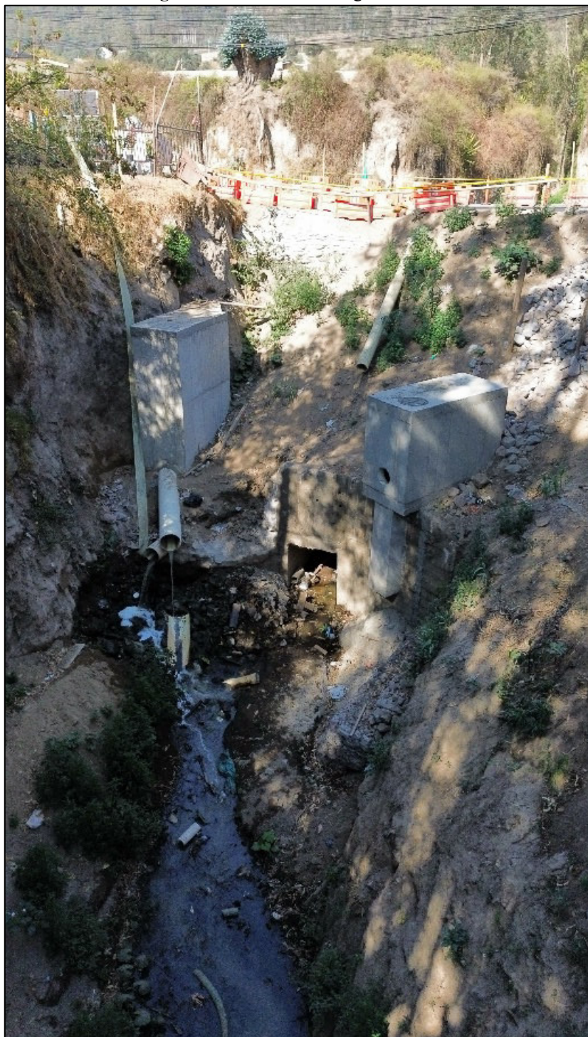
Imagen 10. Contaminación aguas residuales
