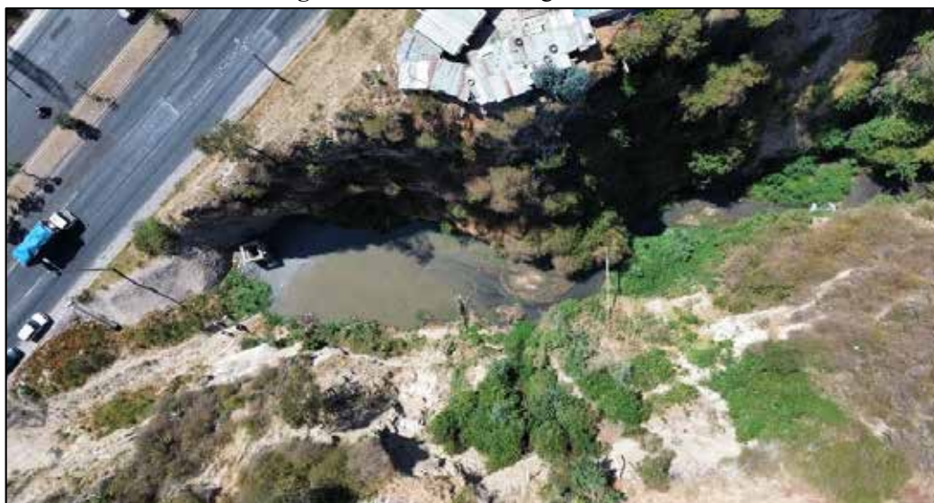
Imagen 5. Contaminación aguas residuales
