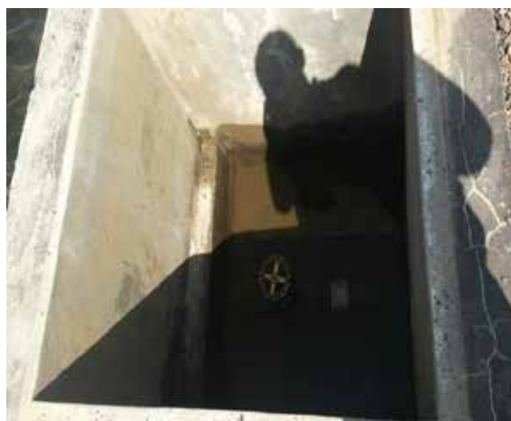
Cámara de lavado Hidráulico del filtro
