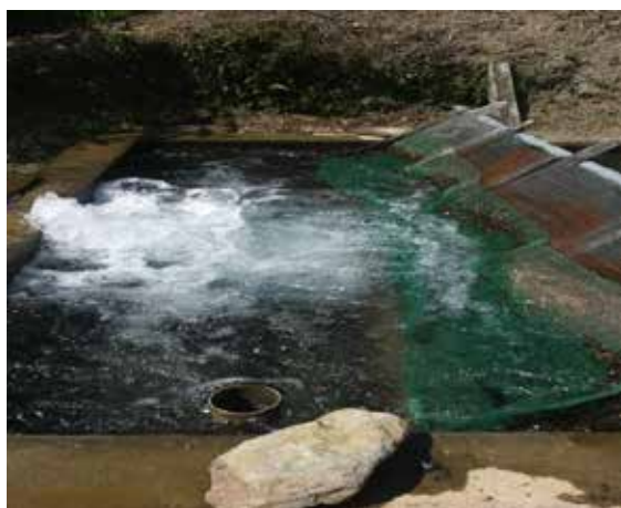
Rebose del agua en cámara de entrada
