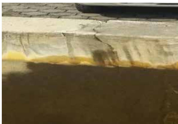
Estado de Paredes del Filtro
