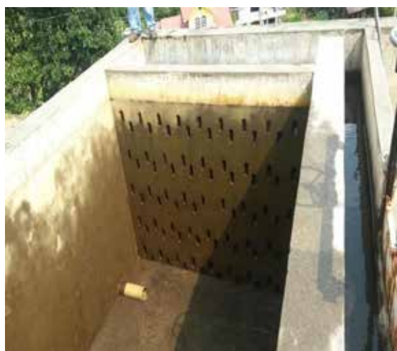
Sedimentador y pantalla deflectora
