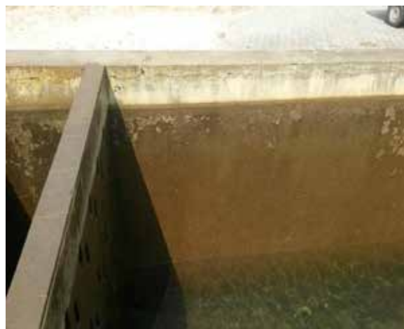
Estado de Paredes del Sedimentador
